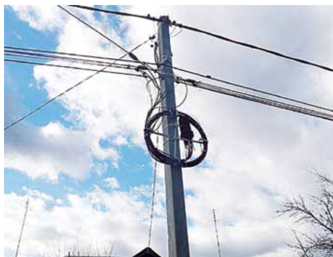
Рис.1. "Кабель-муфта-сварка", недопустимый подвес ОК пучками
