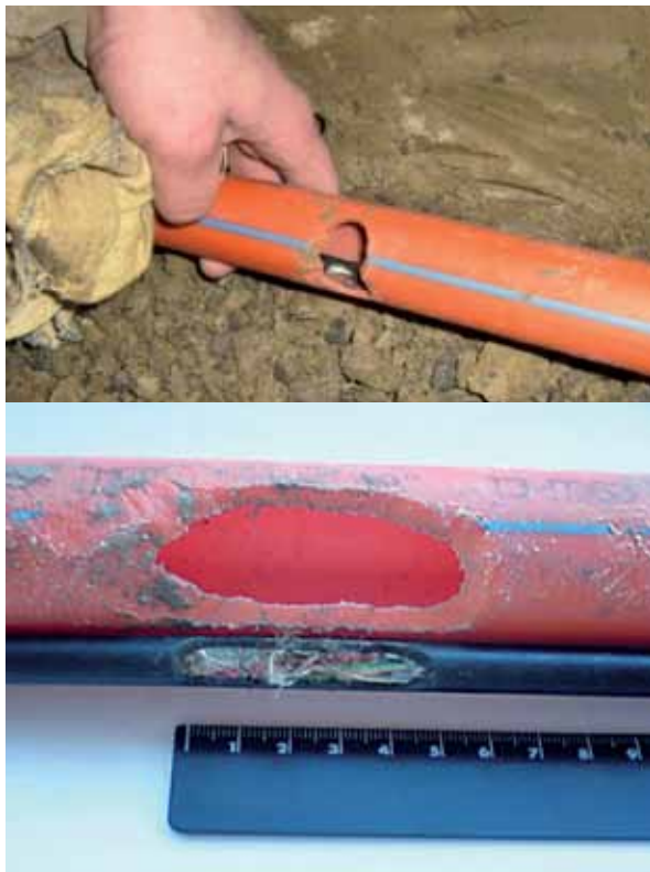
Рис.1. Повреждения кабеля в ЗПТ грызунами
