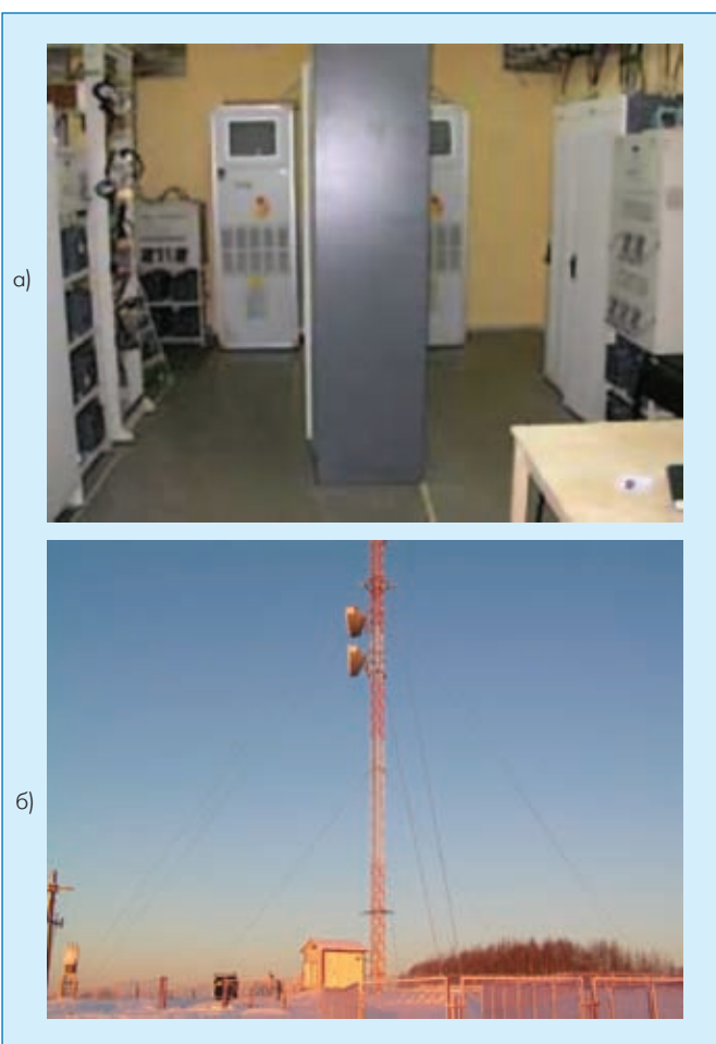
Рис. 1 Объект сотовой связи изнутри (а) и снаружи (б)
