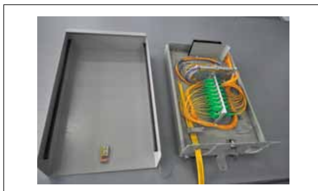
Рис.3. Ящик ЯКГМ-ОВ-34 с установленным сплиттером PLC 1×16
