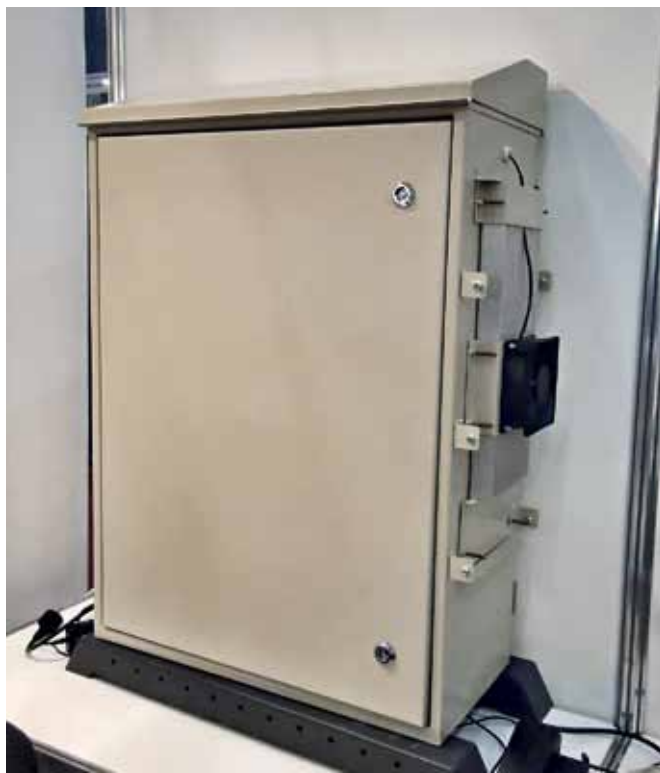
Участковый шкаф из комплекса оборудования для охраны периметра стационарных объектов производства "НАТЕКС"
