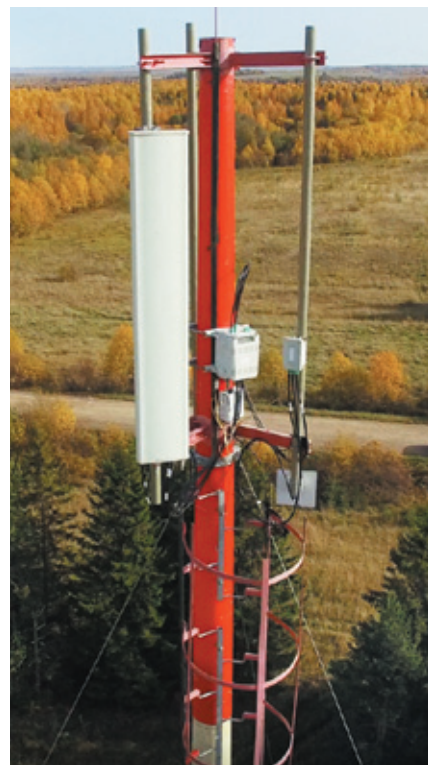
Оборудование oDAS RADIUS на композитной мачте в д. Сыга-2 (Республика Удмуртия)
