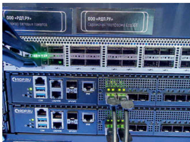
Оборудование RDP на стенде "Ростелекома"
